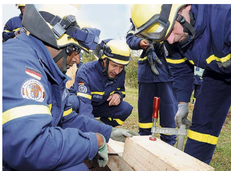
Mitarbeiter des Technischen Hilfswerks verschrauben Bohlen, die ein Haus abstützen sollen. FOTO: BECKER&BREDEL
